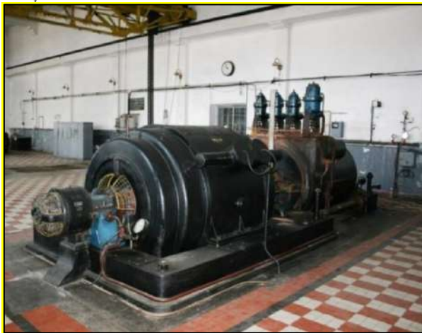
Turbină Brown Boveri din anii '30, ce a funcționat până aproape de închiderea rafinăriei, păstrată in situ și în prezent. Foto Mihail Neagu
